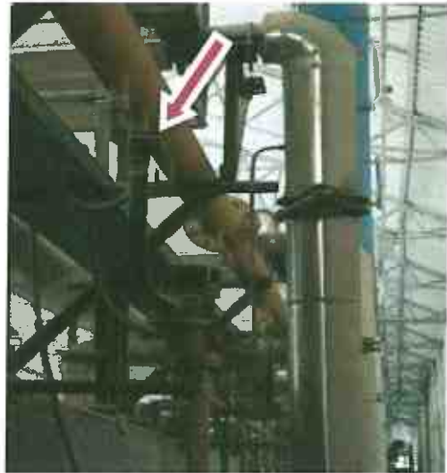
Rampa gas per alimentazione dei bruciatori Forno 1
