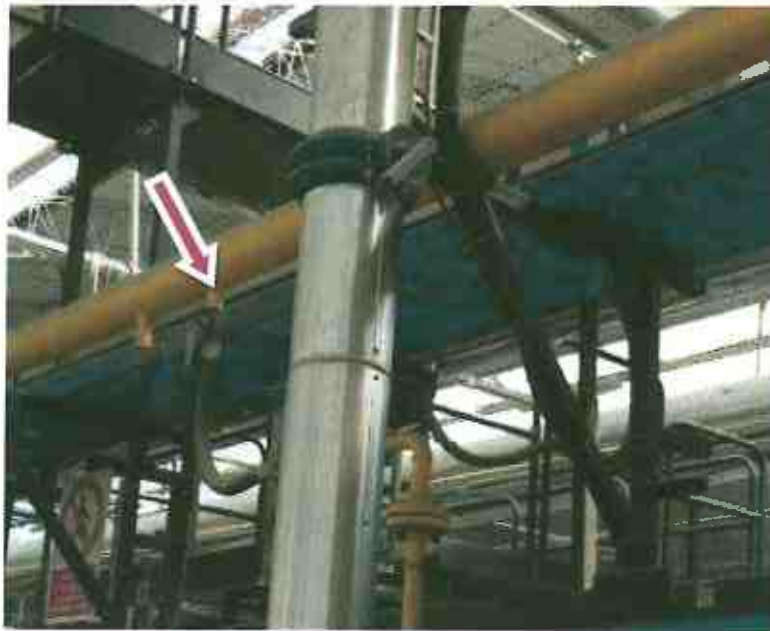
Rampa gas per alimentazione dei bruciatori Forno 2
