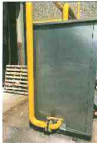
Valvola su tubazione in arrivo da cabina metano su armadio riduzione 3,2/05 Bar
