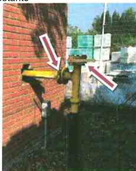
Tubazione di adduzione gas, da cabina metano a stabilimento
