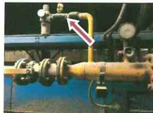
Rampa gas principale per Forno 1
