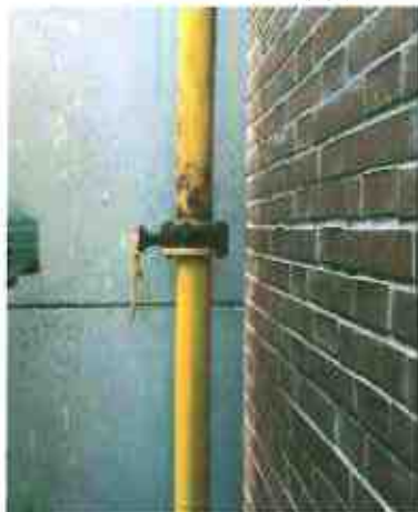
Valvola gen. su tubazione in arrivo da cabina metano
