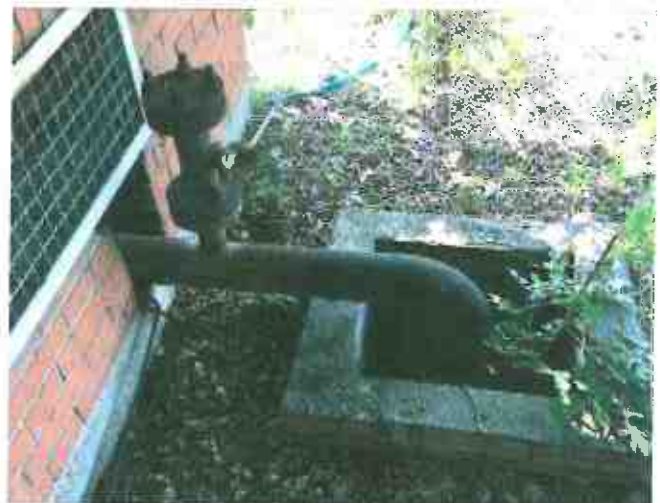
Tubazione d'ingresso gas a cabina metano
