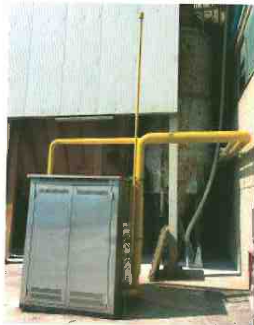
Vista frontale dell'armadio riduzione del gas metano
