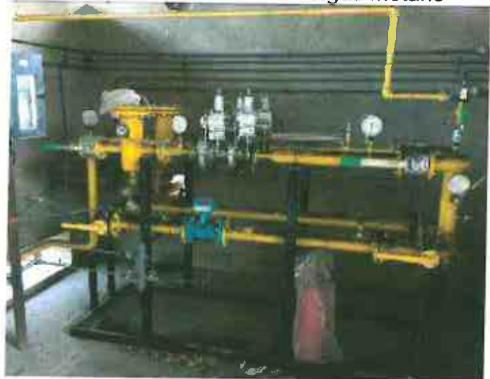
Zona riduzione gas da 12 Bar a 3,2 Bar
